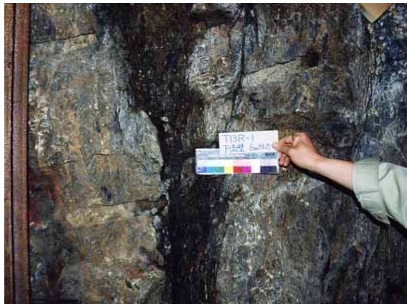
写真 - 3.5.7 黒色泥岩の劣化部 (T13R-1 坑下流壁 6m付近) (珪質粘土岩中には、50cm～1m間隔で幅5～15cmの黒色泥岩を挟在する。そのうち、6割程度は、高角度の層理面に沿ったせん断面が発達し軟質化している。D級 (D、～、2))
