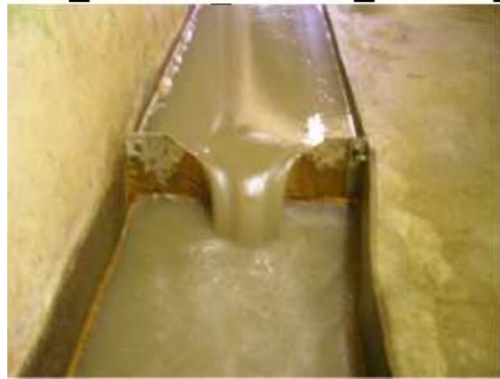
写真－ 2.3.1 出水時の4BL漏水の状況(平成15年4月)
