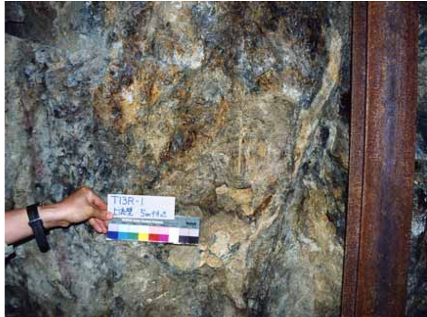
写真-3.5.6 珪質粘土岩の岩盤劣化部 (T13R-1 坑上流壁 5m付近) (全体に褐色～黄褐色化し、潜在的なクラックが発達し、岩片の一部は軟質化している。CL～D級 (C～B、～、2～1))
